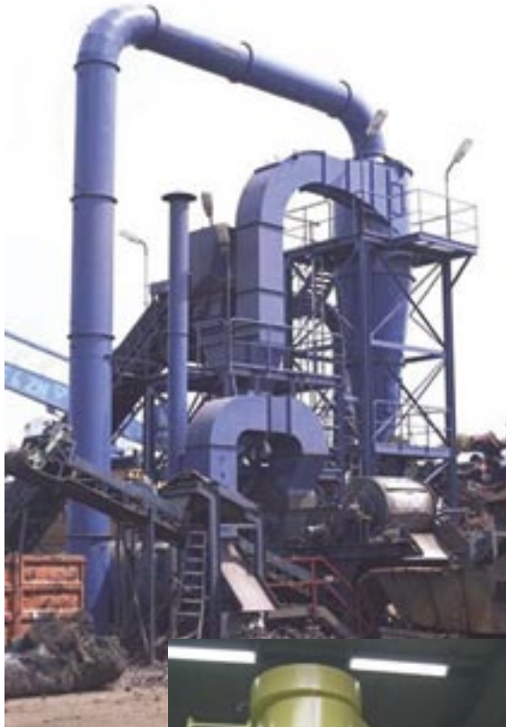
Cycloon met een capaciteit van 46.000 \text{m}^3/\text{h} , geplaatst bij een Shredderinstallatie voor het afscheiden van 14 \text{m}^3 afval-product per uur.
