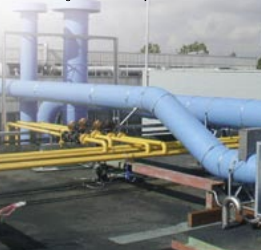
Afzuiginstallatie afvullijn chemische industrie
