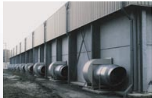
Ventilatoren type A36 1/2 voorzien van geluiddemper voor graandroging; totaal capaciteit 530.000 m 3 /h.
