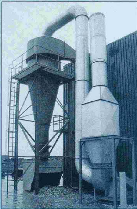
Glasrecyclinginstallatie cycloon 2200 mm \varnothing met dubbel kamersluis, Ventilator B 24 \frac{1}{2} , cap. 22.800 m 3 /h, Leeseringen, W.Duitsland.
