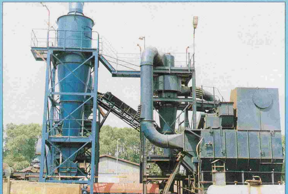
Cycloon geplaatst bij Shredderinstallatie, afvoer door draaisluis met een diameter van 1000 mm. Ventilator B 33, capaciteit 46.000 m 3 /h. Totale hoogte installatie: 14 meter.
